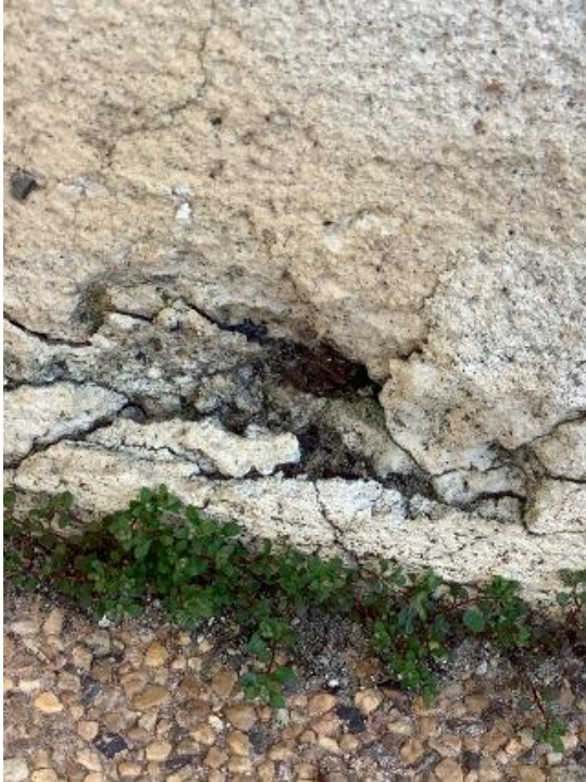
Enduit Souffles et fer a beton
